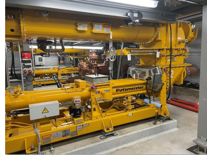
2 x Bunkeraustragschnecke + 2 KS-Pumpen
